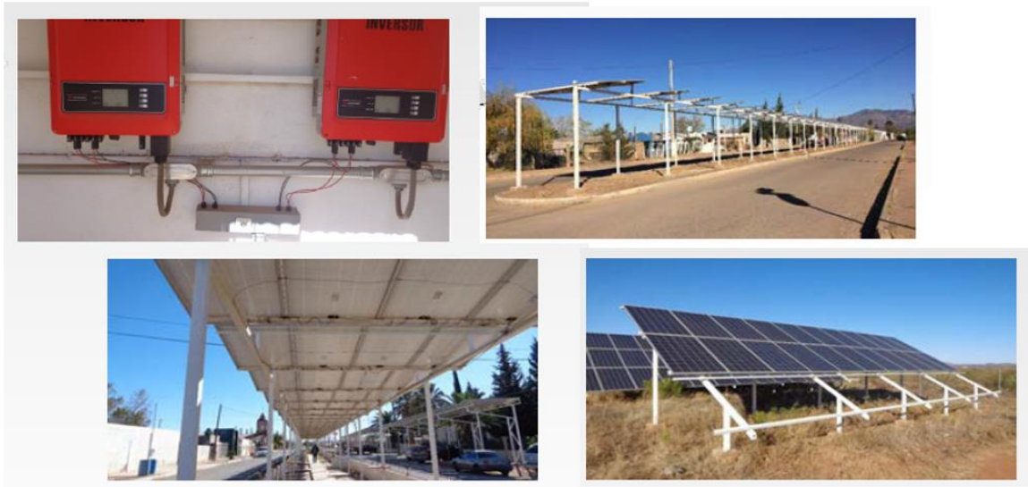
Figura 3 SISTEMA DE PANELES SOLARES
